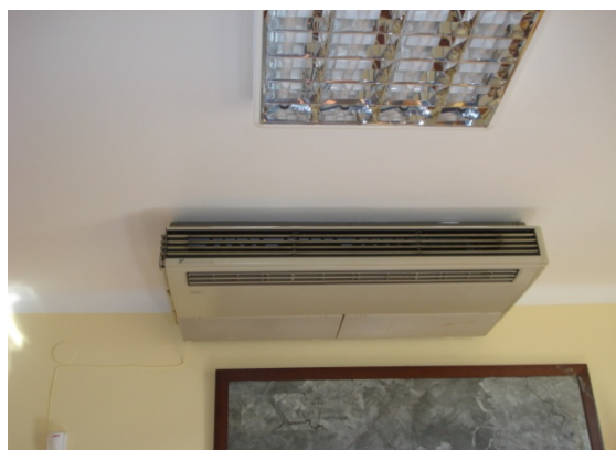
Fotografia 2: Aire condicionat. (Font: Elaboració pròpia. Any 2011)
