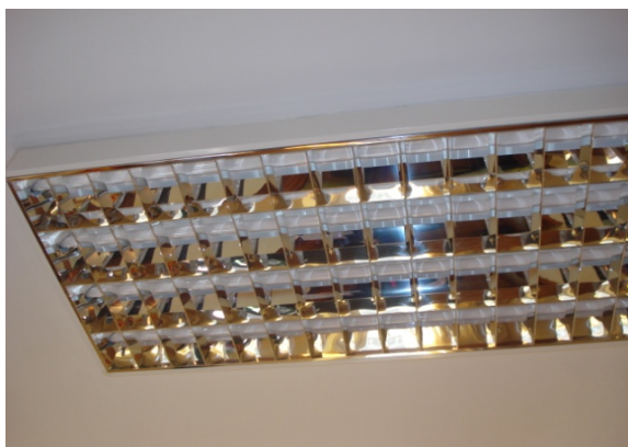
Fotografia 1: Fluorescents 36W. (Font: Elaboració pròpia. Any 2011)
