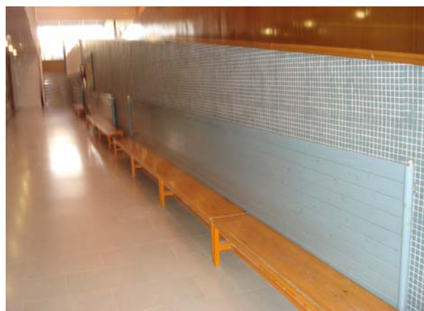
Fotografia 3: Radiador passadís. (Font: Elaboració pròpia. Any 2011)
