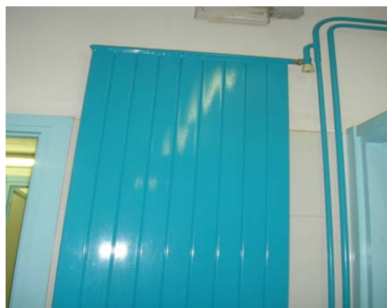
Fotografia 4: Radiador lavabo. (Font: Elaboració pròpia. Any 2011)
