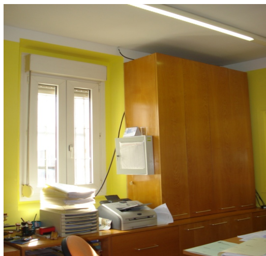
Fotografia 5: Finestres PVC doble vidre amb cambra d'aire (Font: Elaboració pròpia. Any 2011)
